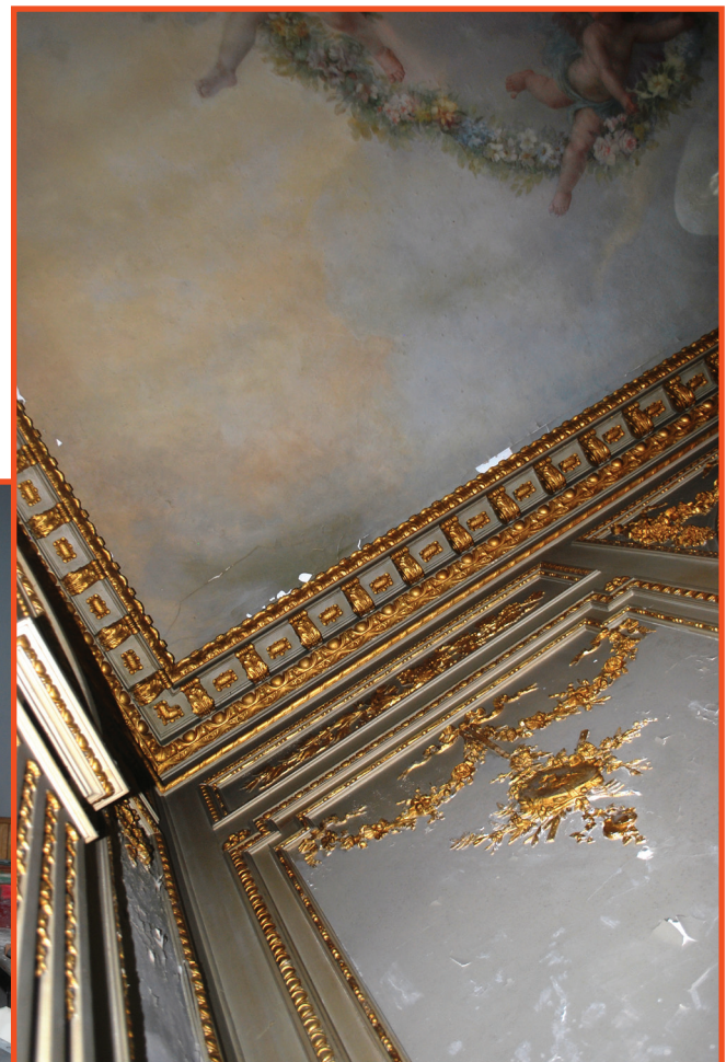
14.- Deterioro en paredes y cielorraso. 2019.
